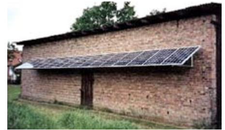
Fassadenanlage (Fotovoltaik): eine von vielen Gestaltungsmöglichkeiten auf der Hofinnenseite Quelle: www.cbesolar.de
