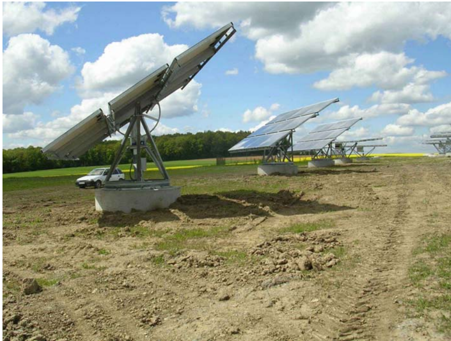
Abb. 3-1: Mover-Anlagen im Solarpark Gut Erlasee (Gemeinde Arnstein, Unterfranken), Fläche ca. 77 ha (Quelle: Bosch & Partner GmbH)
